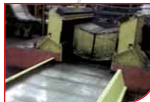
Protection de fosse
